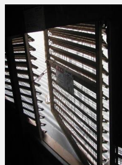
Metal louvre door
