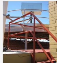
Access to RF equip
